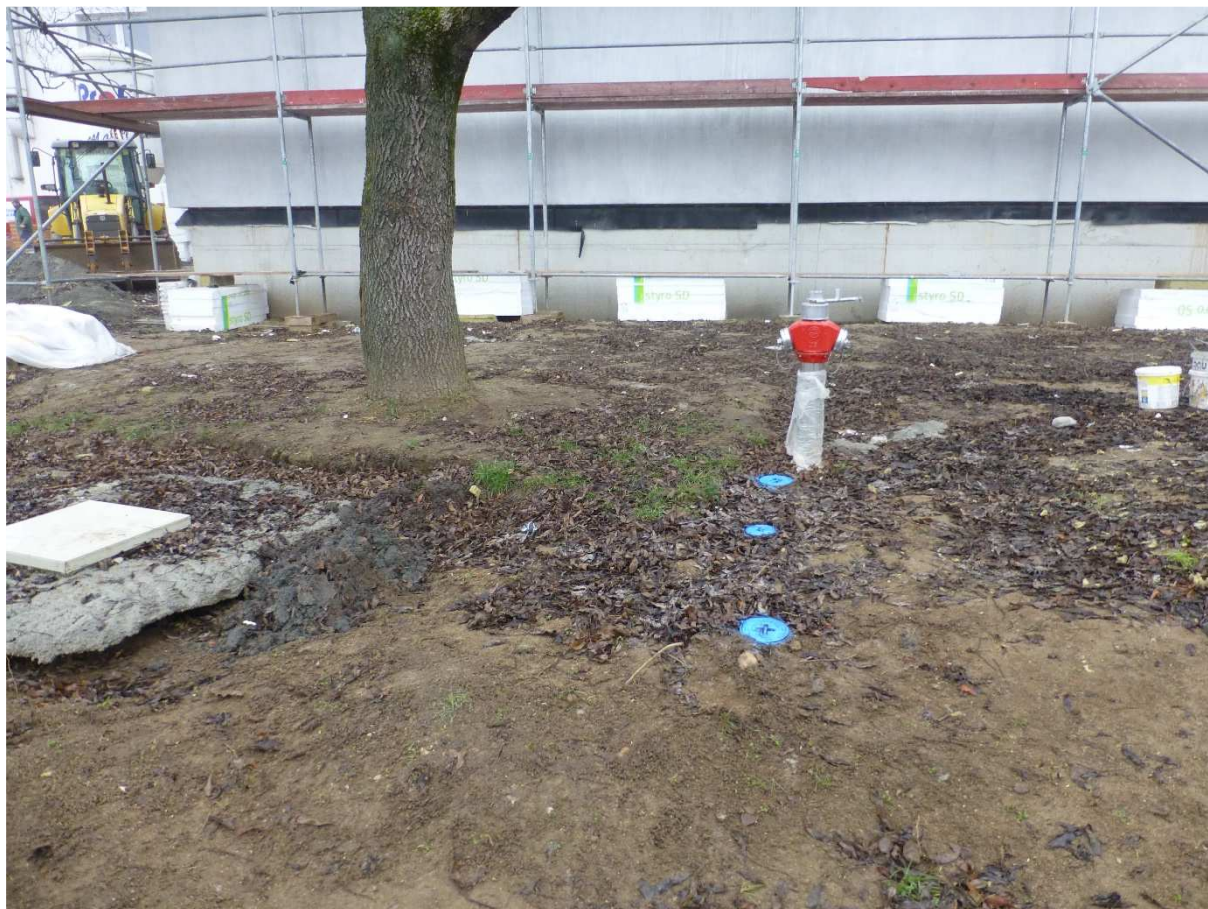
Obrázek 3: Umístění požárního hydrantu na parcele 827 místo stávajícího podzemního hydrantu H57. Nutno přepojit na potrubí min DN 80.
